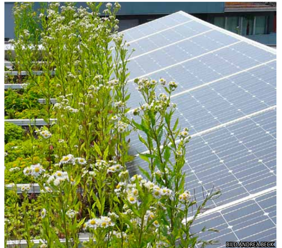
Schattenwurf auf Solaranlage durch Dachbegrünung. Hier besteht Handlungsbedarf.
