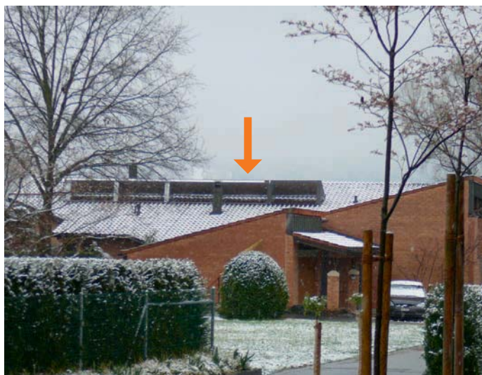
Solarbau 2.1: Thermische Solaranlage aufgeständert
